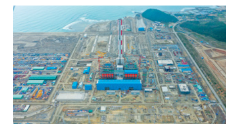
The 1,320 MW Van Phong 1 power plant, Khanh Hoa, Vietnam // Nhà máy nhiệt điện BOT Vân Phong 1 1.320 MW, Khánh Hòa, Việt Nam
