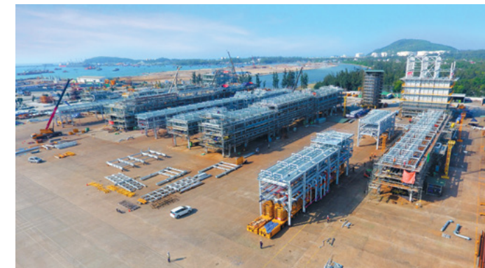
The module assembly area for the Sarawak Methanol project // Khu vực lắp ráp mô-đun cho dự án Sarawak Methanol
