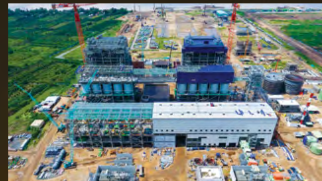
Nhà máy Nhiệt điện Sông Hậu I 1.200 MW
