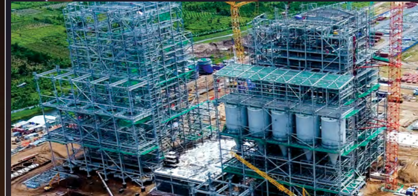
Công trường xây dựng Nhà máy Nhiệt điện Sông Hậu 1, Việt Nam
