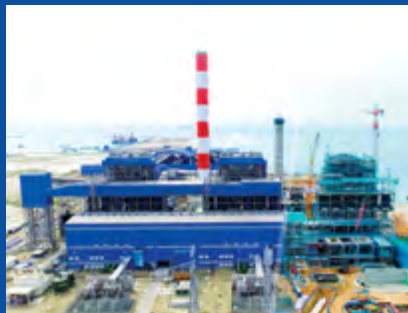
Nhà máy nhiệt điện Nhiệt điện Vĩnh Tân IV 1.200 MW và Vĩnh Tân IV mở rộng (phải) 600 MW đang được xây dựng tại tỉnh Bình Thuận, Việt Nam
