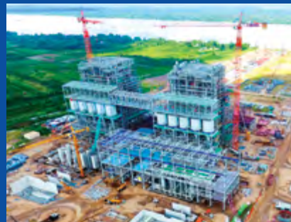
Nhà máy Nhiệt điện Sông Hậu I 1.200 MW, tỉnh Hậu Giang, Việt Nam đang được xây dựng
