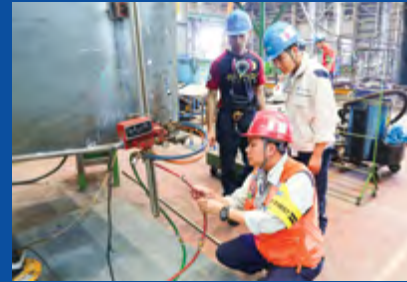
Anh Đặng Văn Khánh, đội An toàn EHS (ngồi) kiểm tra đường ống dẫn gas và khí đốt tại nhà máy Boiler
